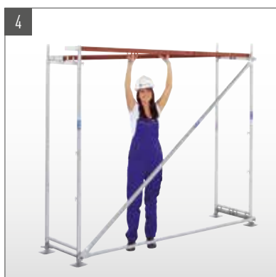
4 Montar las plataformas, alinear perpendicularmente las barandillas y los bastidores verticales mediante un nivel.
