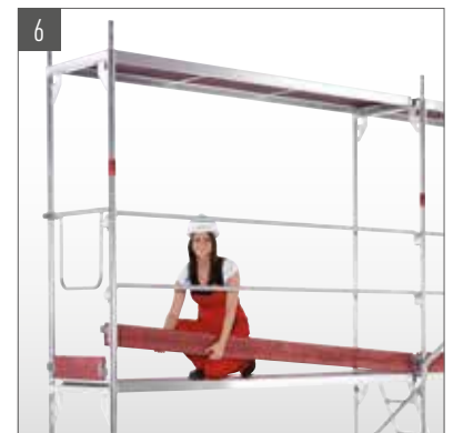
6 Stellrahmen und Beläge der nächsten Lage montieren, Diagonale, Geländer und Bordbretter einhängen.
